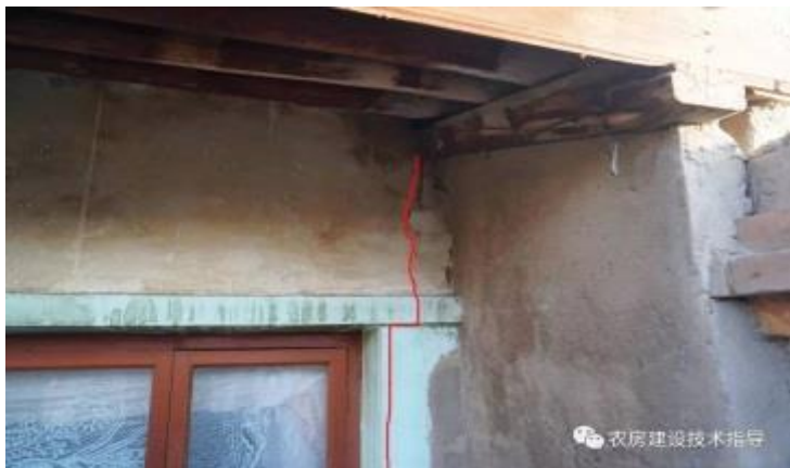
木梁和椽子局部腐朽、泛白
