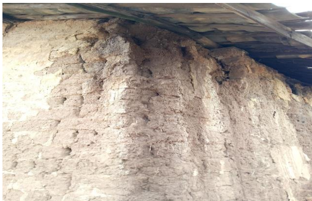
墙体出现裂缝、坍塌
