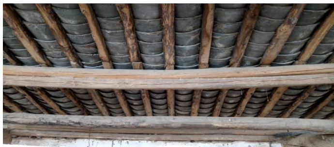
屋面局部塌陷
