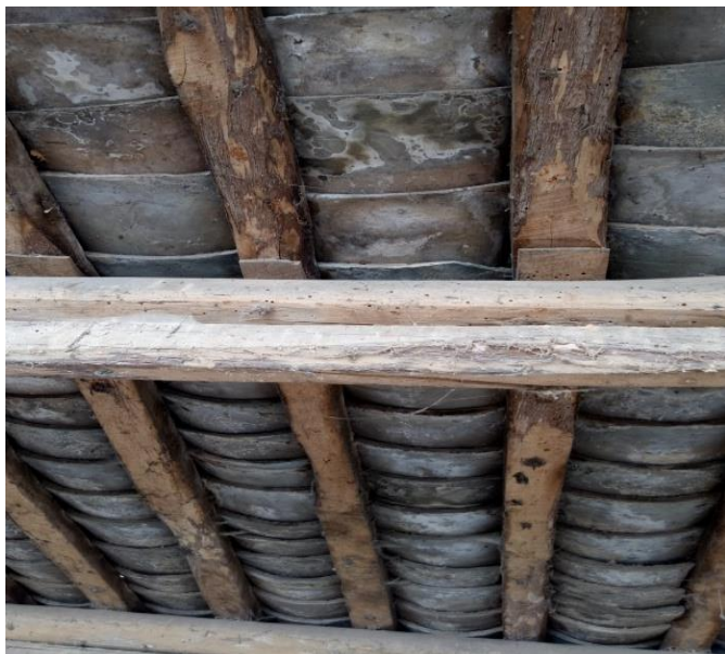
屋面木梁腐朽损坏、塌陷
