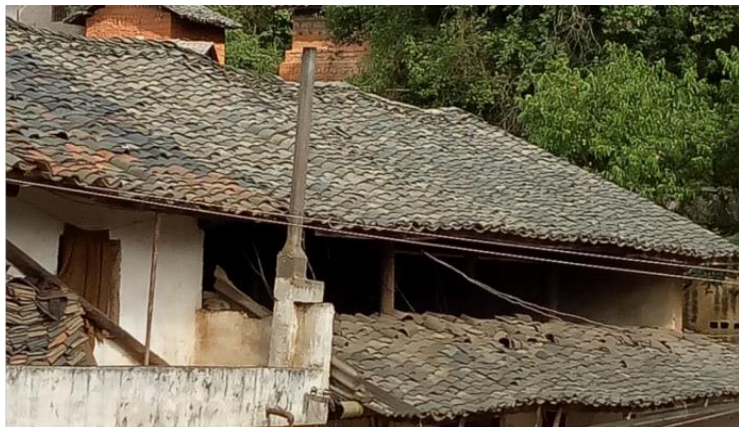
屋面局部坍塌
