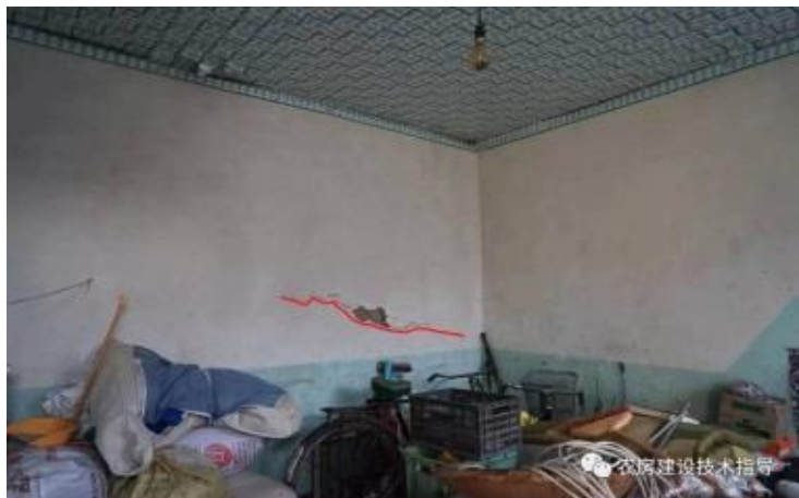
内墙面砂浆面层有剥落
