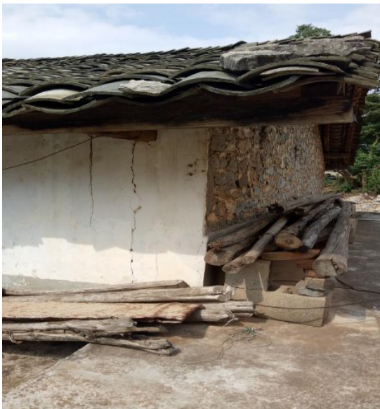
屋面木梁腐朽损坏、塌陷
