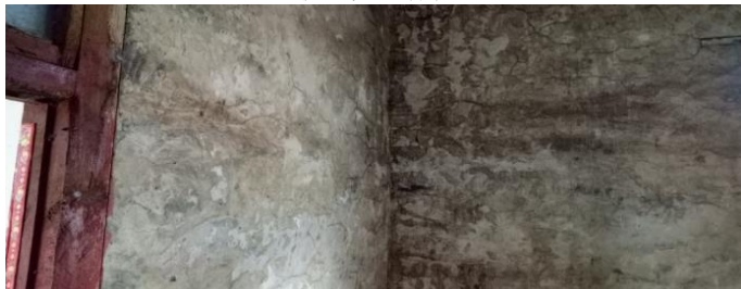
纵横墙体交接处裂缝
