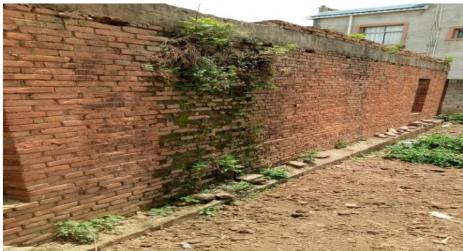
地基基础、墙体浸水
