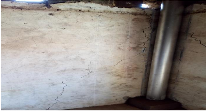
墙体出现裂缝
