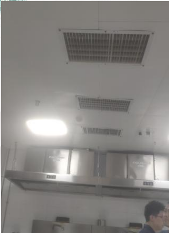
天然气厨房的空调风口
