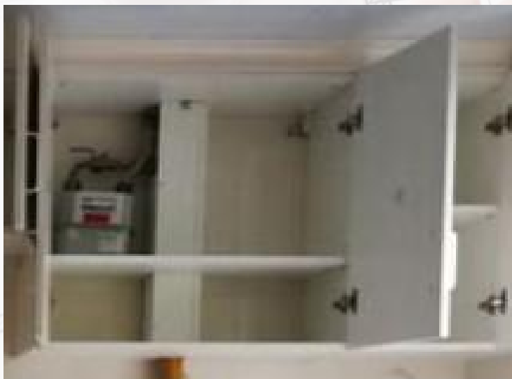
安装在上橱柜内
