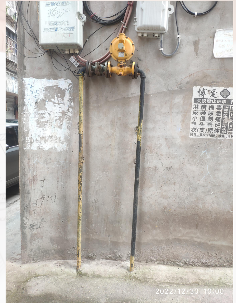
无防雷接地，无超压切断阀
