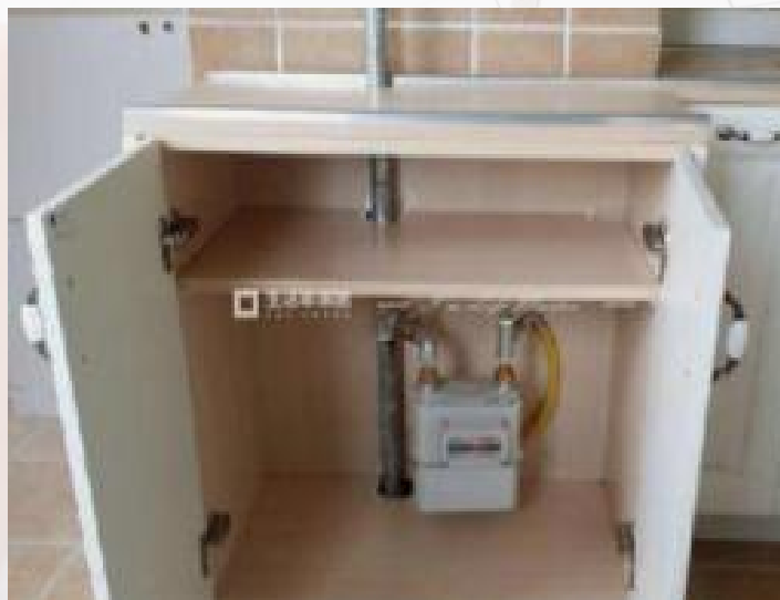
安装在下橱柜内
