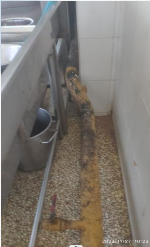
管道锈蚀严重
