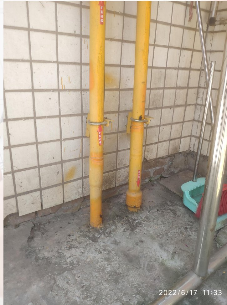
无防雷接地，钢塑接头出地面
